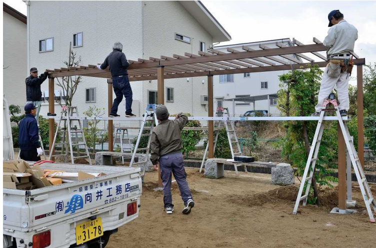
▲足場を設け藤棚を設置するゆめづくり委員ら＝小坂公園
